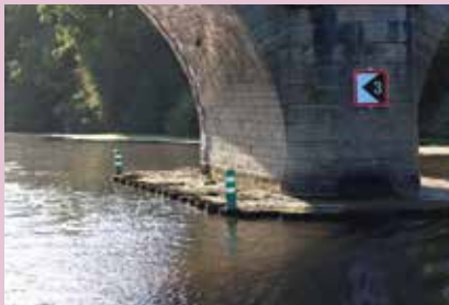
Pont de Droulin. Attention à la base des piliers
